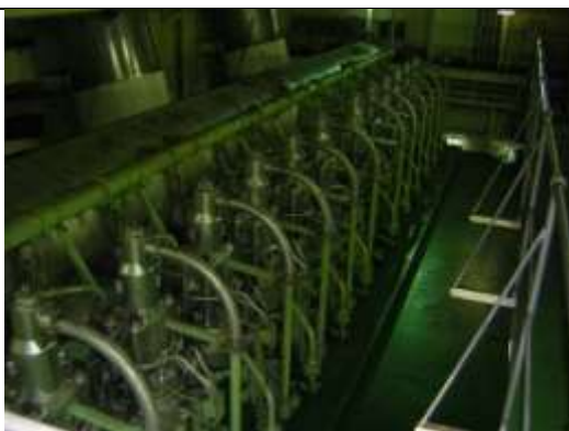
機艙控制室主機
