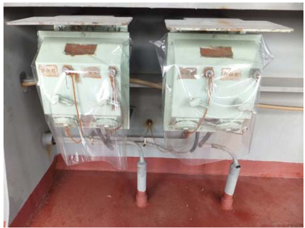
圖 59 甲板側邊的冷凍櫃電力設備
