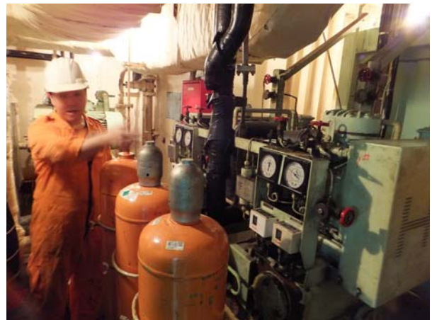
圖 45 威明輪三管現場解說各式機械設備
