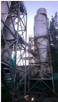
回收煙道廢氣乾燥塔
