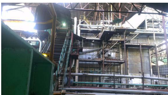
甘蔗壓榨後產生之蔗渣經由輸送帶移至蔗渣發電廠
