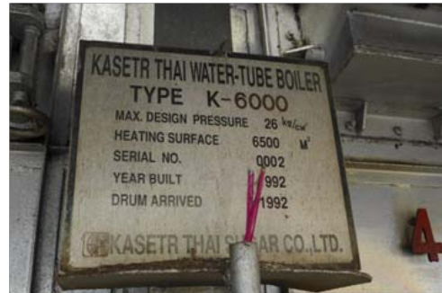
發電廠鍋爐設計壓力為 26 公斤
