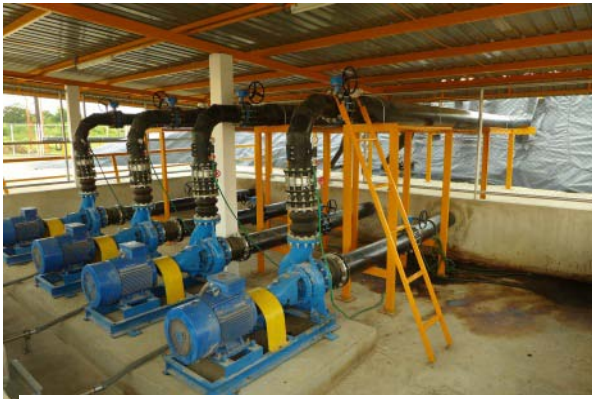
沼氣抽送至糖蜜酒精發電廠的設備
