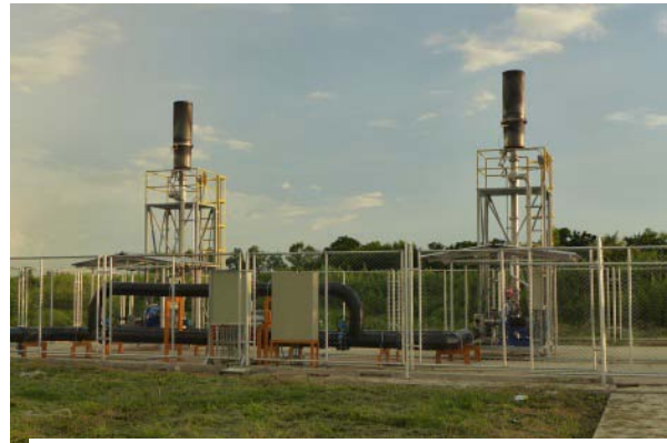
處理過剩沼氣之燃燒塔
