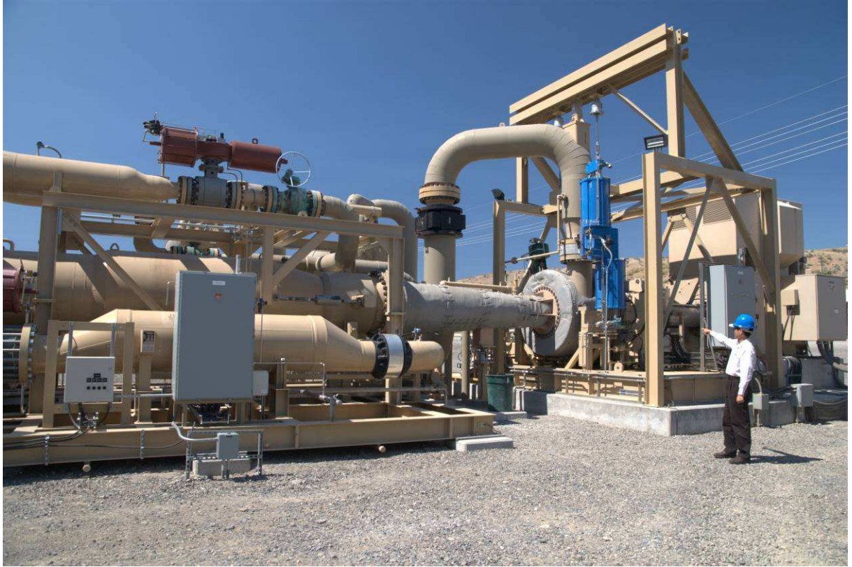
圖 7：Neal Hot Spring 地熱電廠之雙循環發電機
