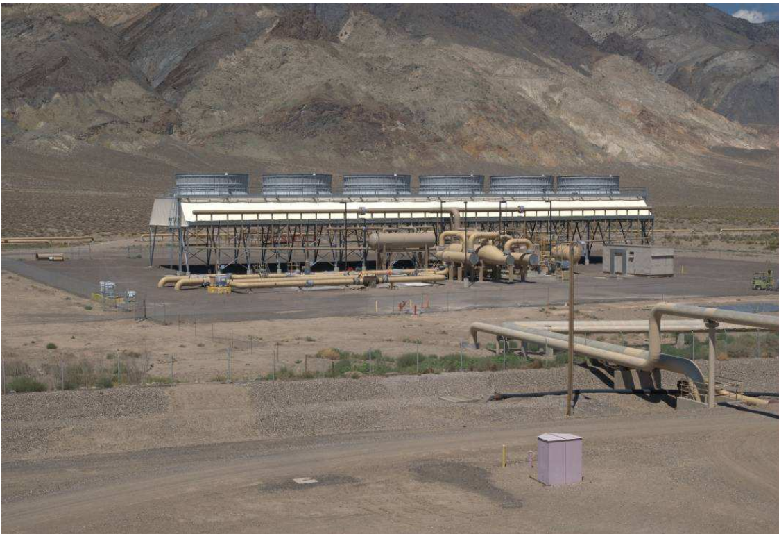
圖16：Dixie Valley地熱電廠6MW雙循環發電機組
