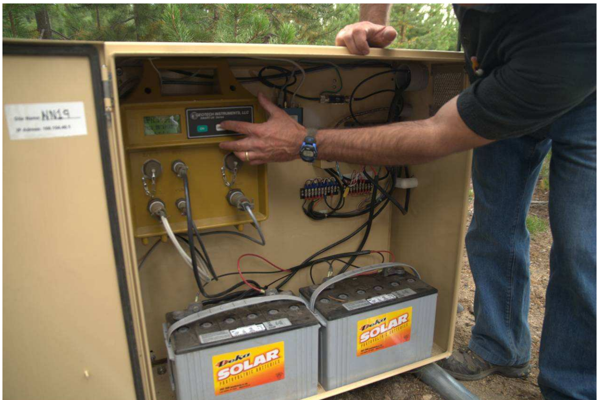
圖26：Newberry EGS示範計畫之震測資料收集設備
