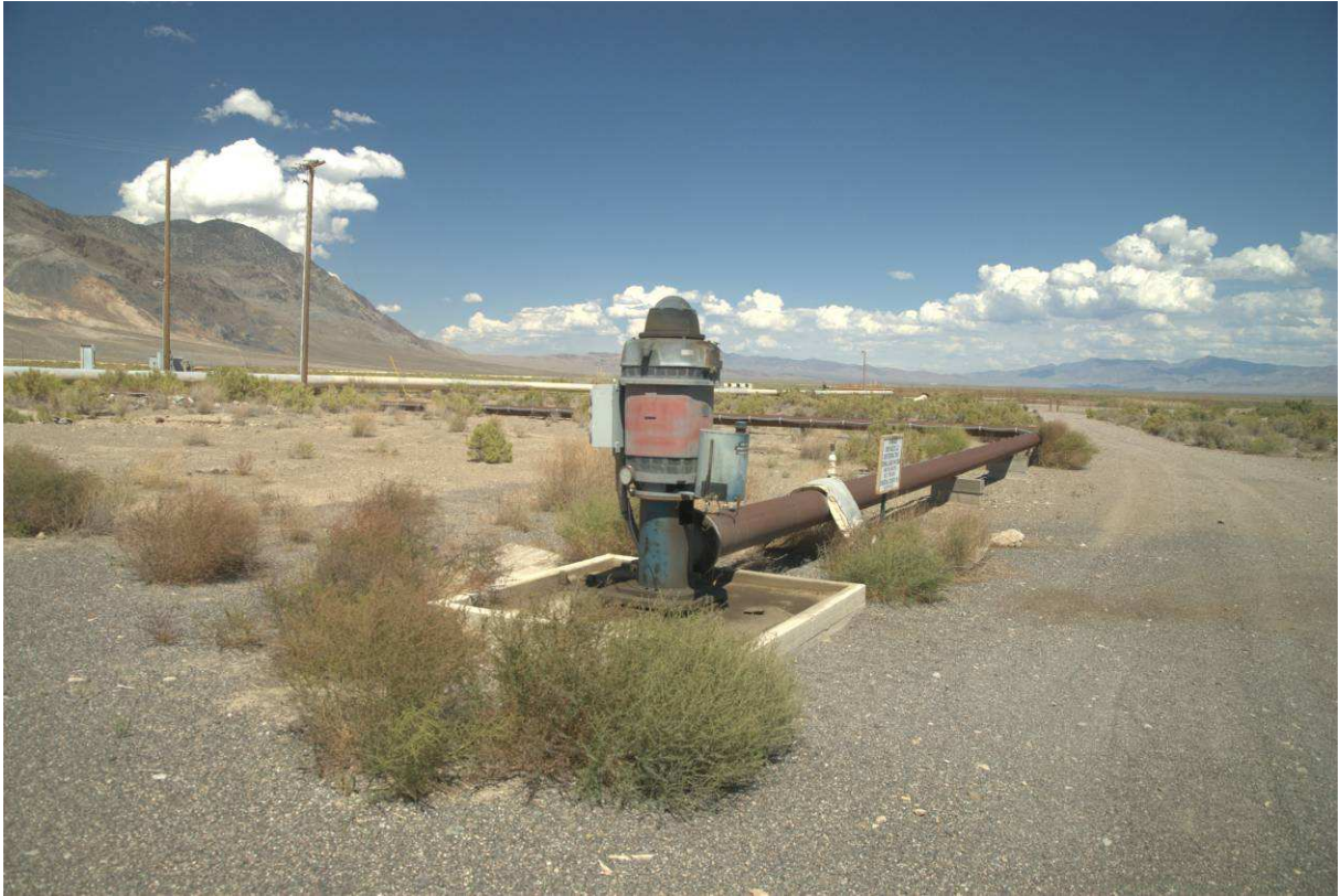
圖21：Dixie Valley地熱電廠用於補充儲集層之地下水井
