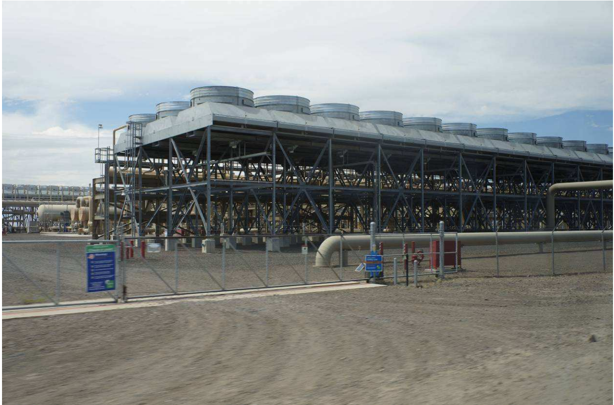
圖10：Stillwater地熱電廠之乾式空氣冷卻塔
