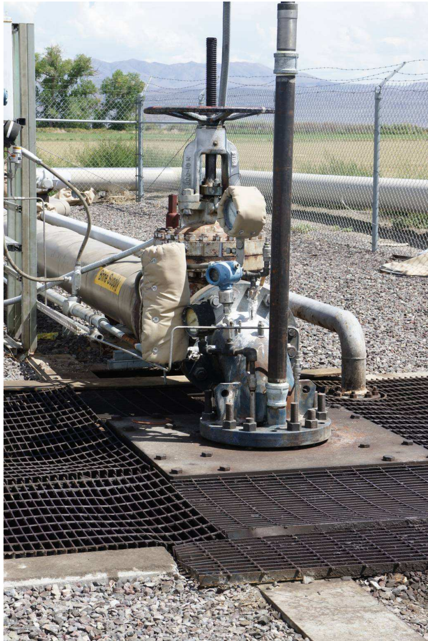
圖9：Stillwater 地熱電廠之生產井
