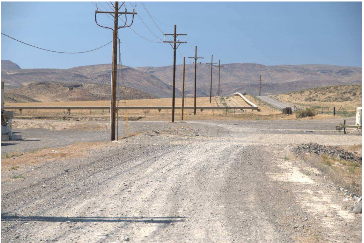
圖 8：Neal Hot Spring 地熱電廠之架空電源線
