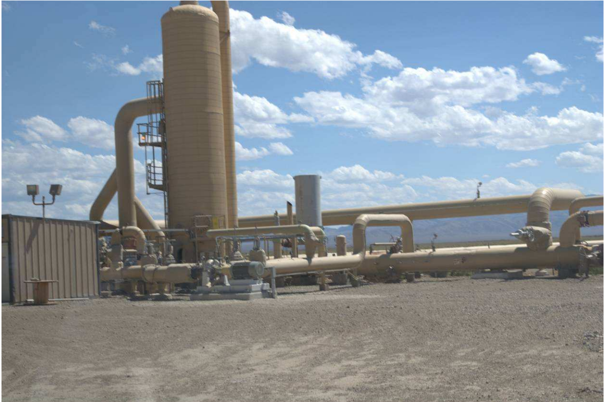
圖 19：Dixie Valley 地熱電廠生產井旁之汽水分離器
