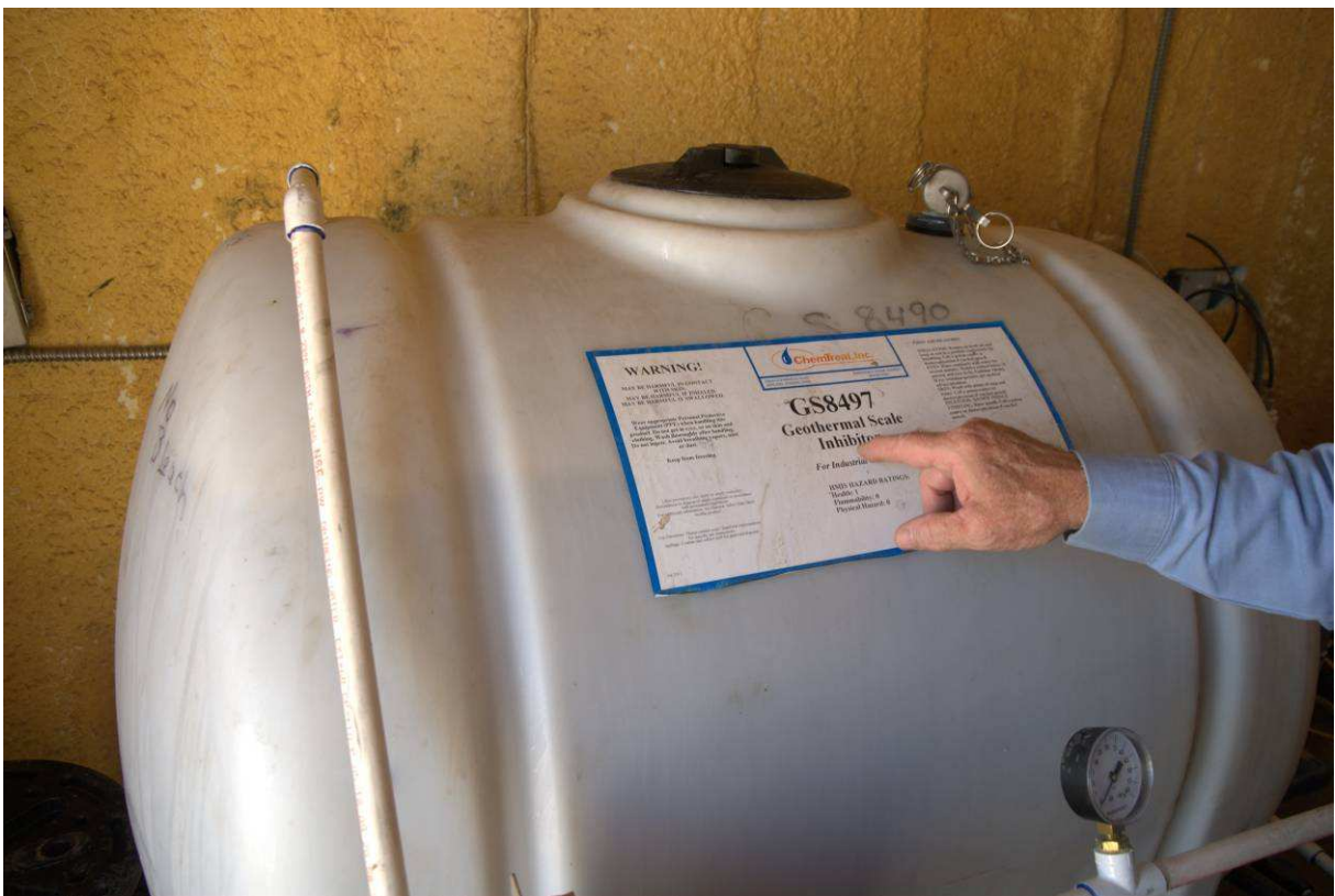
圖20：Dixie Valley地熱電廠使用之結垢抑制藥劑
