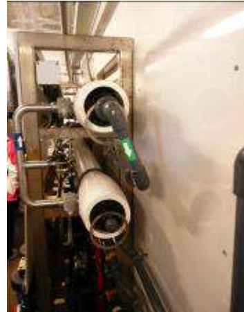
照片 39. DODP 模廠之 RO 測試
