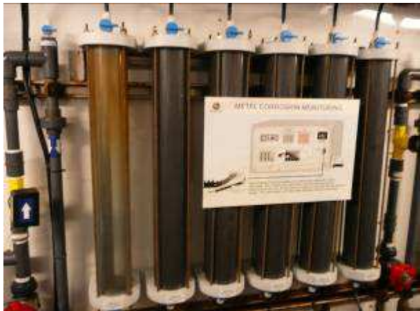
照片 37. DODP 模廠之金屬腐蝕試驗
