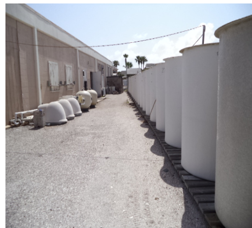
料實驗室之供水及水處理系統
