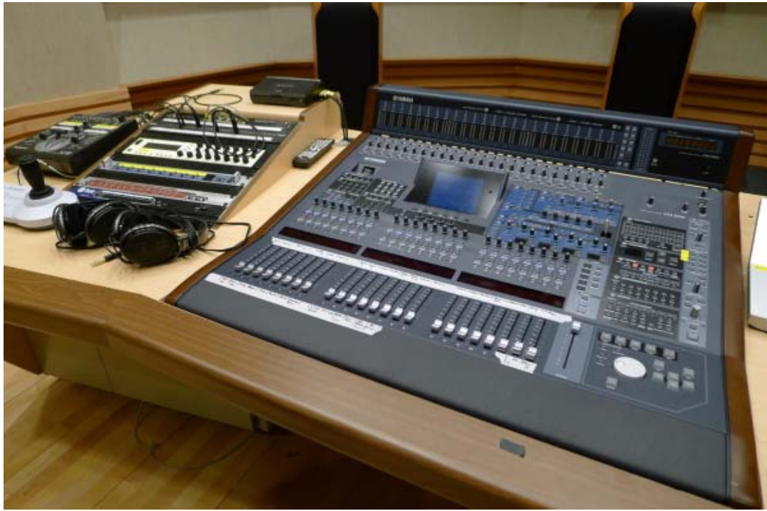
首爾交響樂團排練廳內之錄音室
