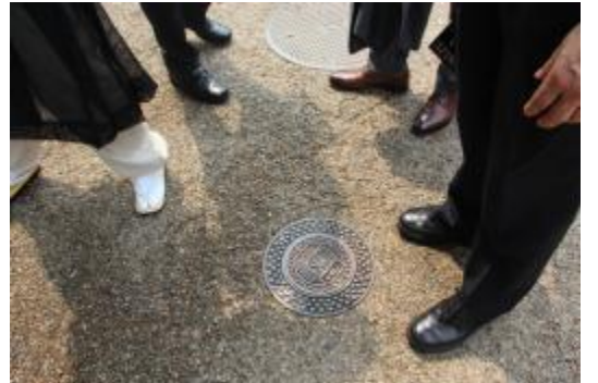
圖 123 地面消防取水口
