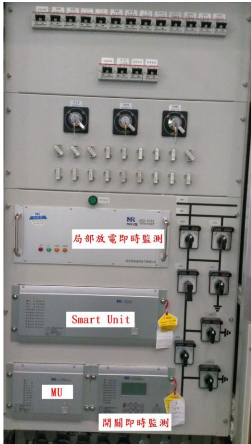
圖 23、控制機櫃盤面
