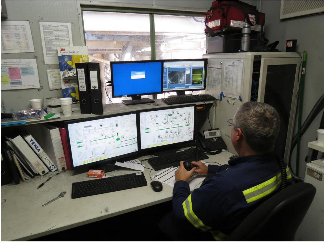
圖40 Narrabri煤礦CHPP控制室內部
