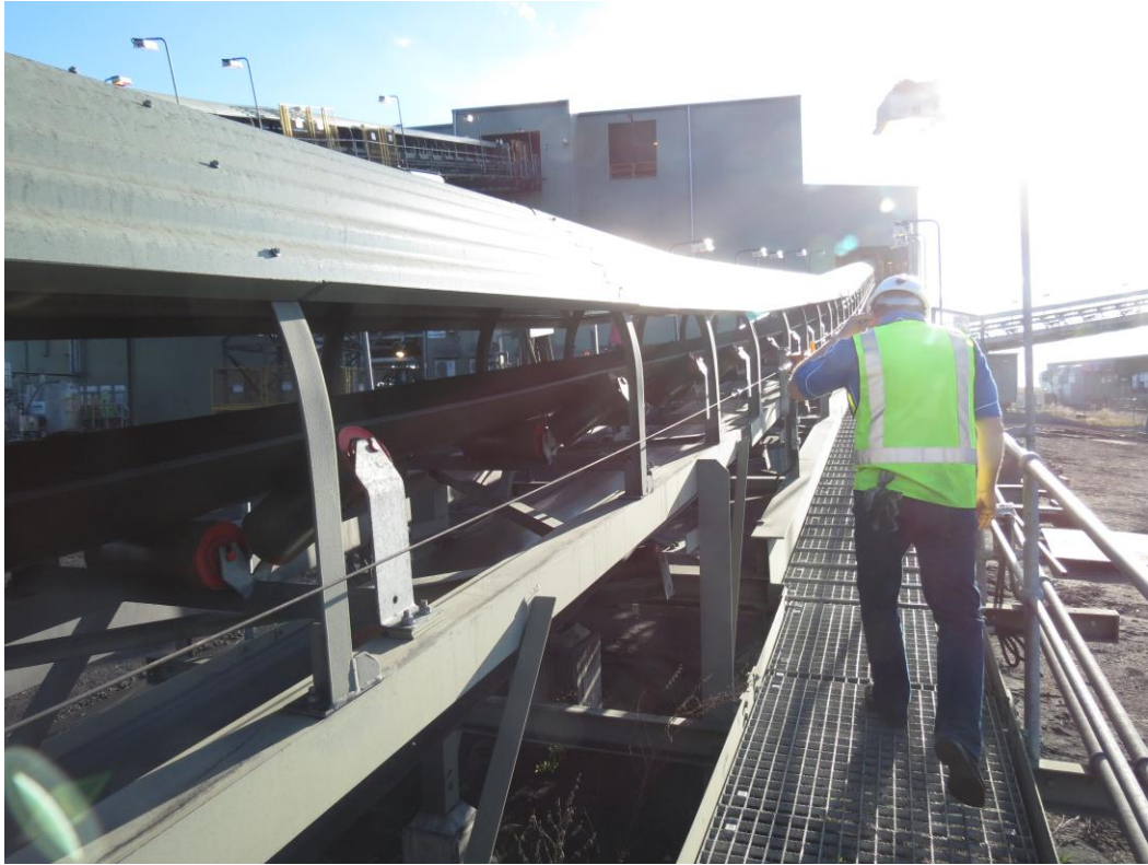
圖36 Narrabri原煤經碎煤後以皮帶機送入CHPP
