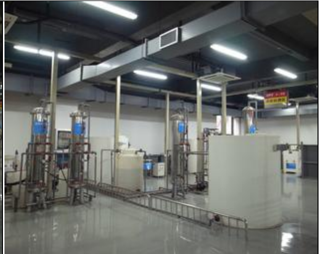
實訓基地水處理訓練設備
