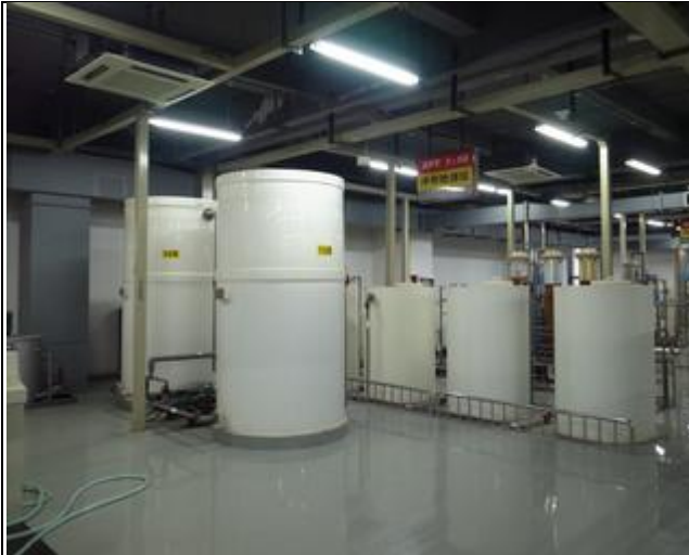
實訓基地水處理訓練設備
