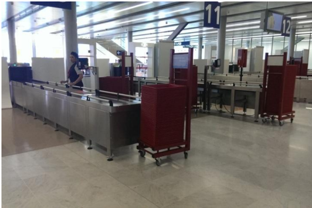
圖 19：衛星航廈 M 的出境安檢設備(前)
