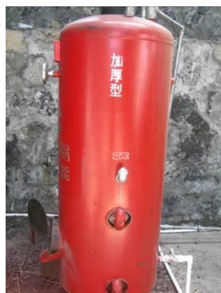
圖 7-7 殺菁室的外接蒸氣鍋爐
