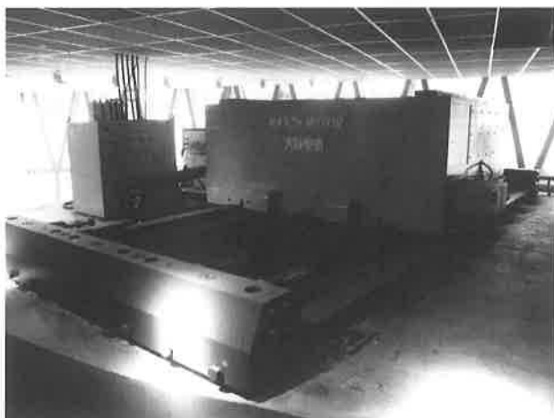
圖九 廣州塔 TMD 上方之 AMD 系統
