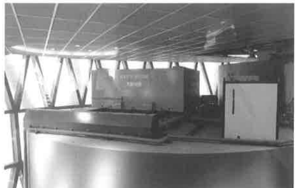
圖六 TMD 上方裝設的 AMD 系統
