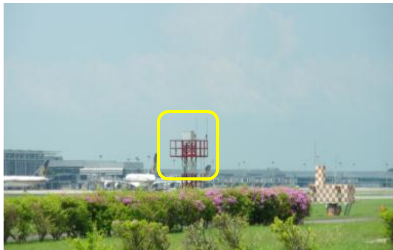
▲ FOD 偵測設備
