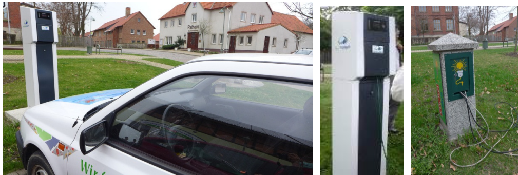
圖 12、電動車充電站
