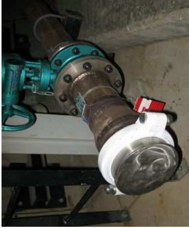
SG补水泵补水接口
