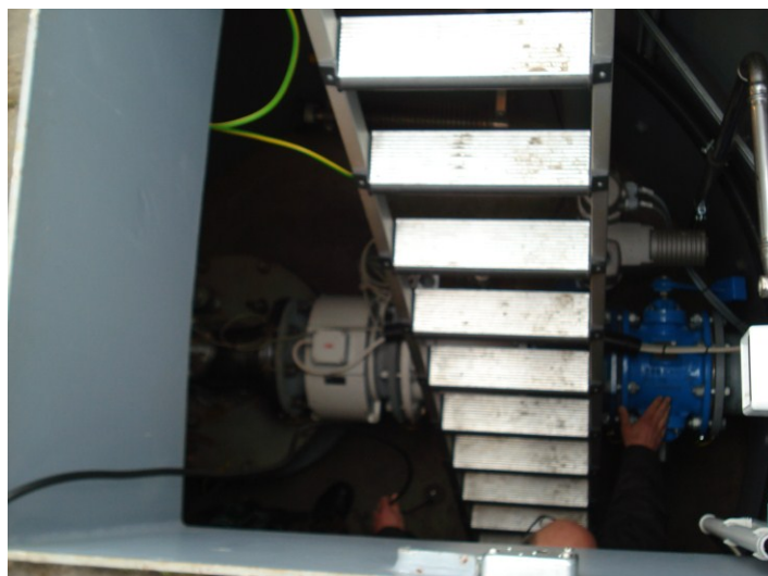
圖 38-12 漢堡水務中/東部(Mitte / Ost)淨水場地下水井操作及監控設備
