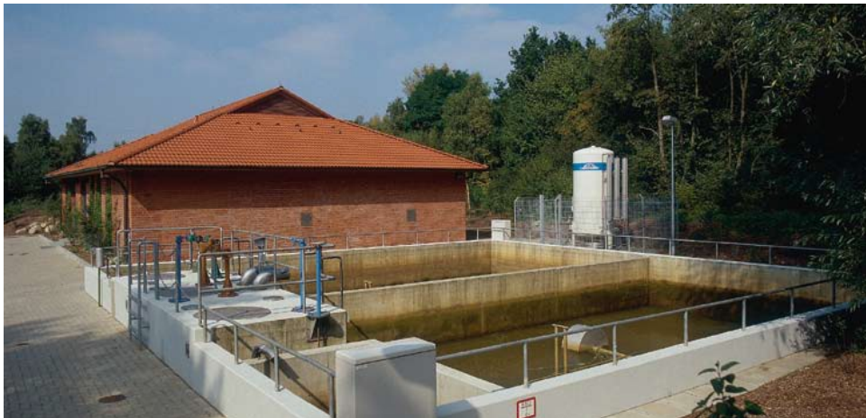
圖 38-11 漢堡水務中/東部(Mitte / Ost)淨水場廢水回收設備(供廠區植物及附近農作用)
