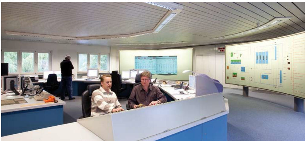
圖 38-8 漢堡水務中/東部(Mitte / Ost)淨水場監控設施
