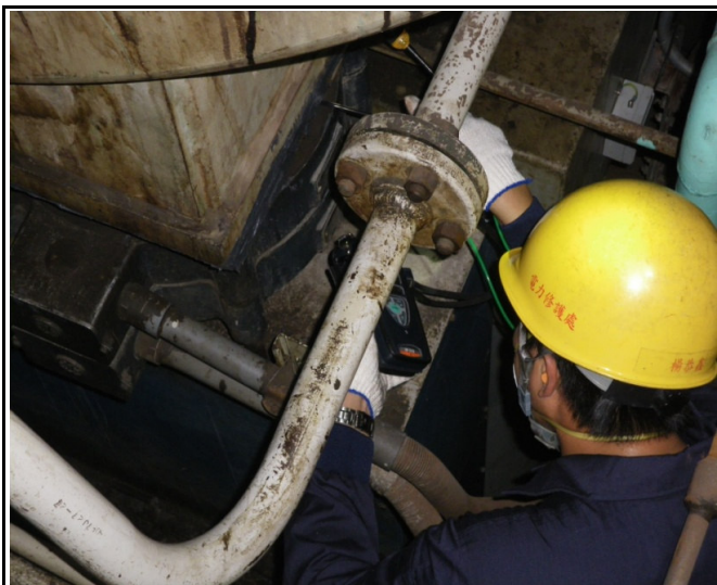
Terminal Plate洩漏檢測
