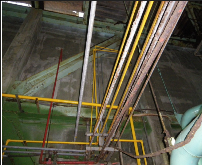
氫氣管線洩漏檢測
