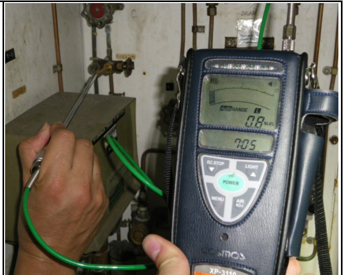
氣體監測盤管路洩漏檢測
