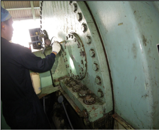
發電機大蓋洩漏檢測
