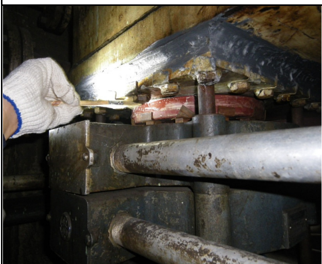
Terminal Plate洩漏檢測
