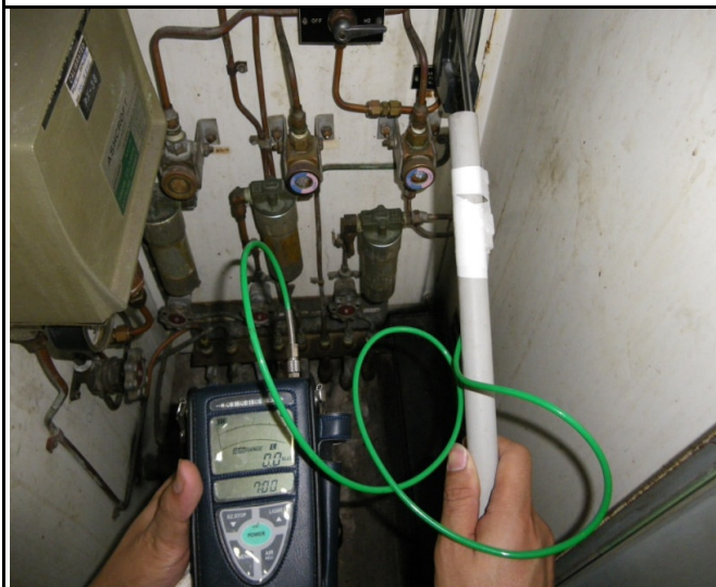
氣體監測盤管路洩漏檢測
