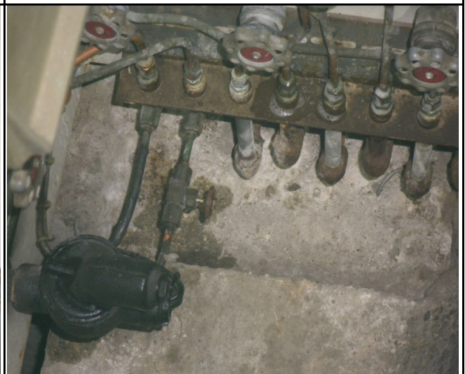
氣體監測盤管路洩漏檢測
