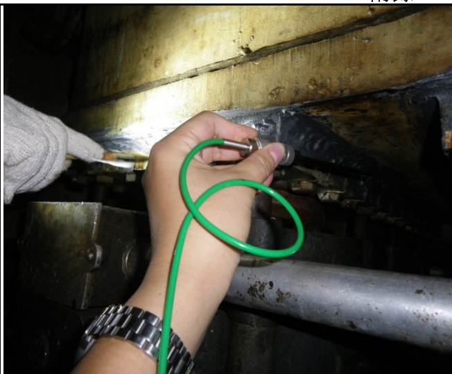
Terminal Plate洩漏檢測
