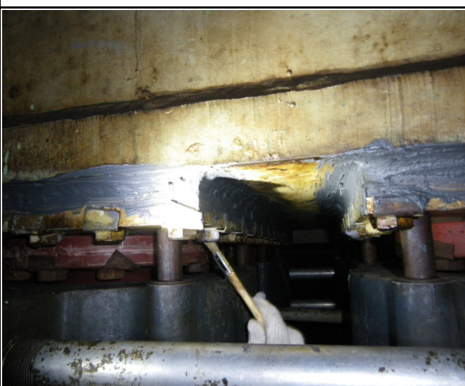
Terminal Plate洩漏檢測
