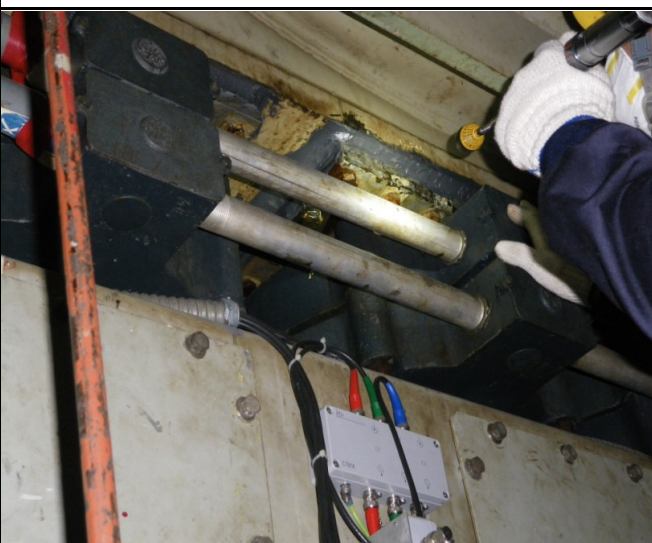
Terminal Plate洩漏檢測
