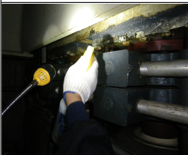
Terminal Plate洩漏檢測
