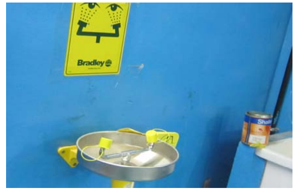
2. 緊急洗眼器(在 UPS 之蓄電池室有洗眼器)
