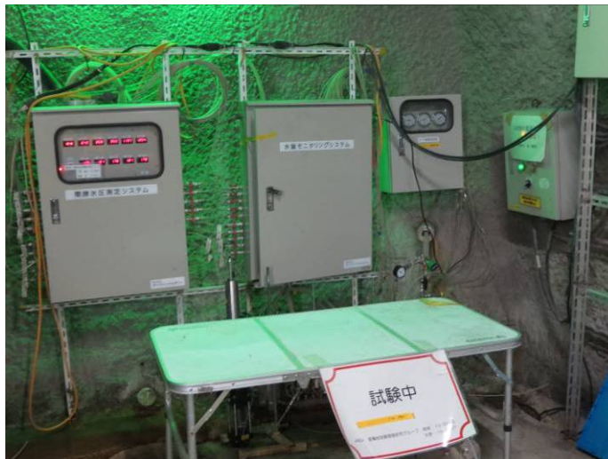
(b)岩層水壓變化自動監測設備
