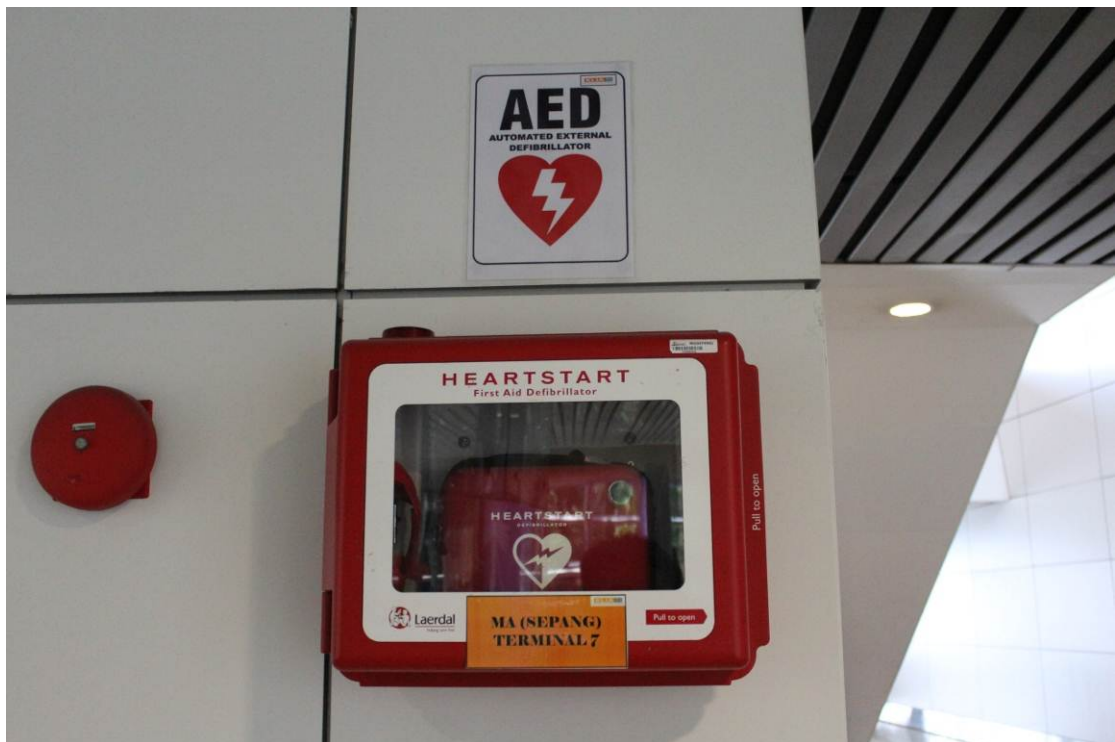
圖 10：懸掛於衛星廊廳牆面之 AED 設備
