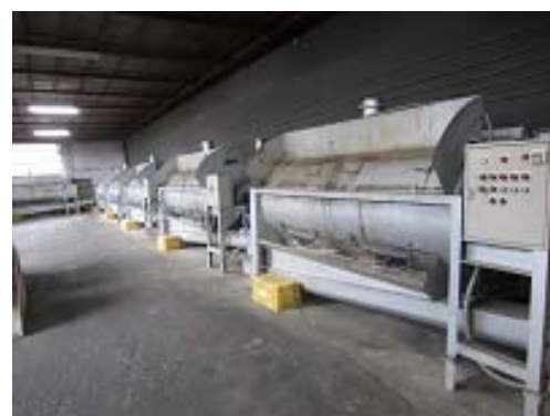
圖 26. 混合飼料設備
