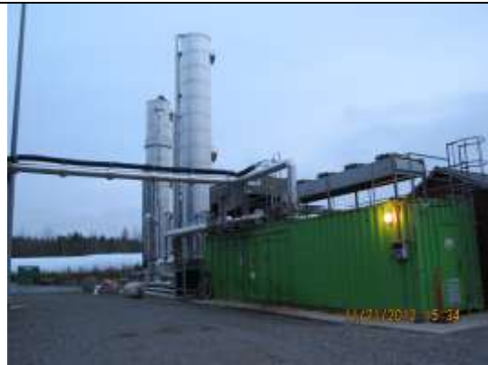
沼氣純化設備
