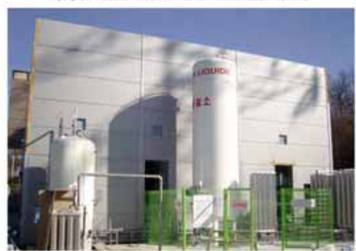
(d)壓力控制裝置及 LN 2 儲存槽
