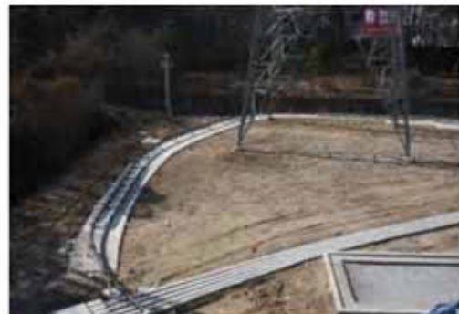
(b)高溫超導電纜在直線佈設
