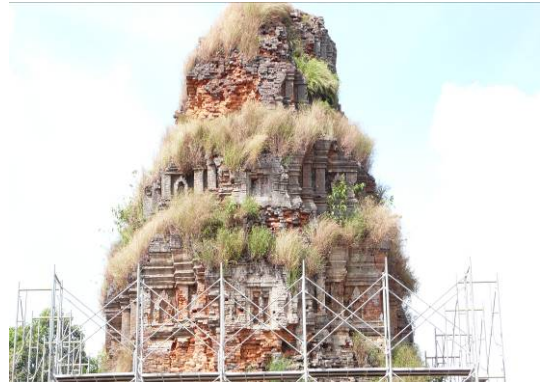
羅蕾寺紅磚尖塔風化受損嚴重
