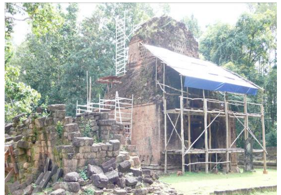
比列科寺修復中搭設的假設工程，固定時並無破壞古蹟本體
