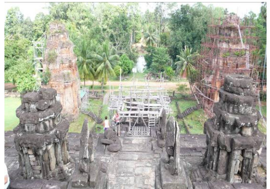
巴孔寺前方左右兩個塔寺及中門，目前仍架設假設工程進行修復中
