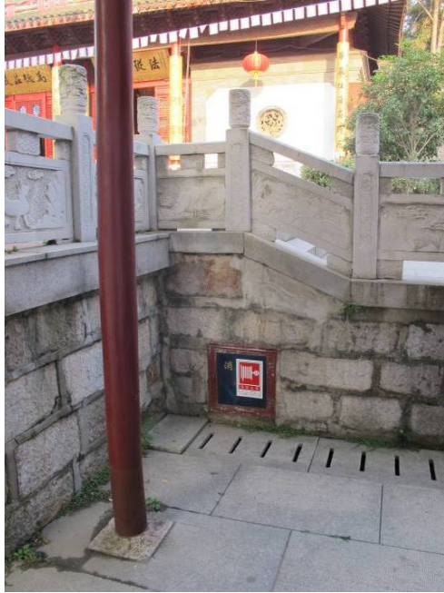
寺廟基礎設置消防栓及水帶
