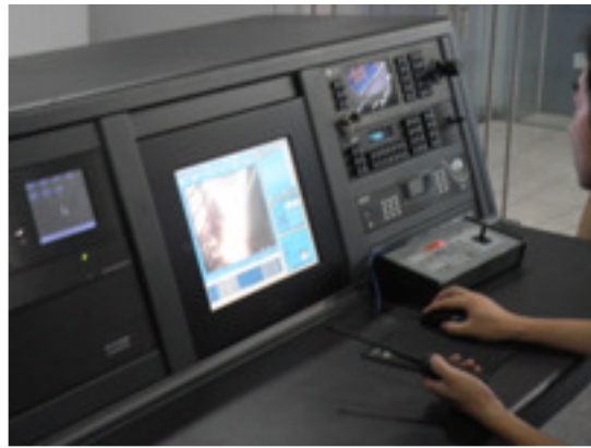
監視控制平台
