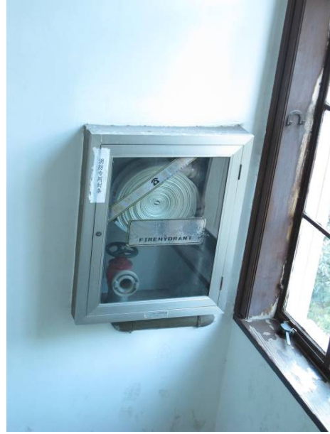
室內消防栓箱 (1)
