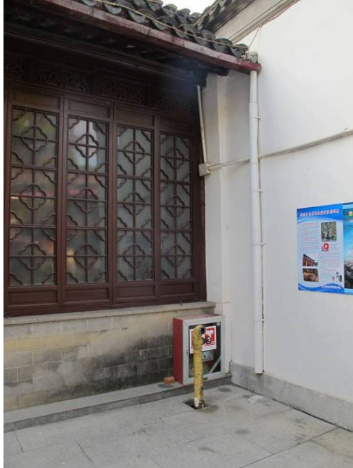
消防水帶及送水口
