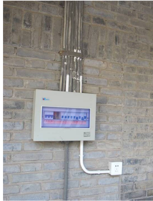
電線套於 PVC 阻燃管
