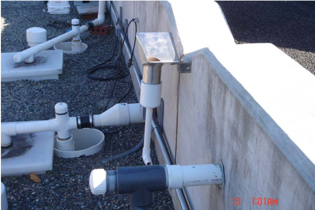
圖 37 Puyallup 研究推廣中心停車場透水試驗監測設備
