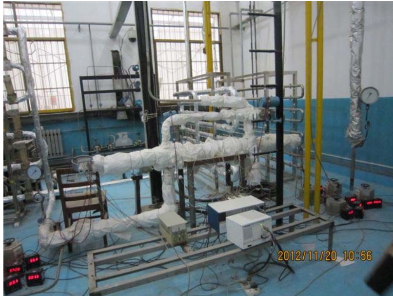
圖十四 西安交大鈉沸騰熱工水力實驗設備
