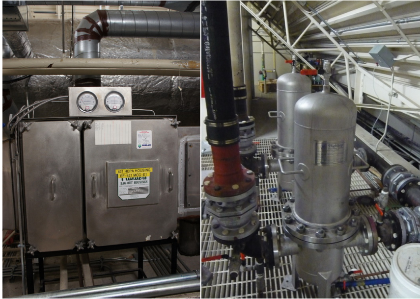
圖十五、左為 HEPA 更換箱；右為鍋爐蒸汽出口濕式過濾器。
