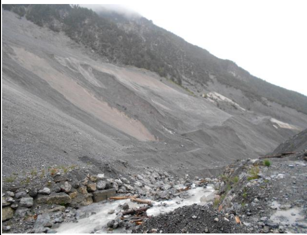
Tyrol 省野溪上游土石崩落情形
