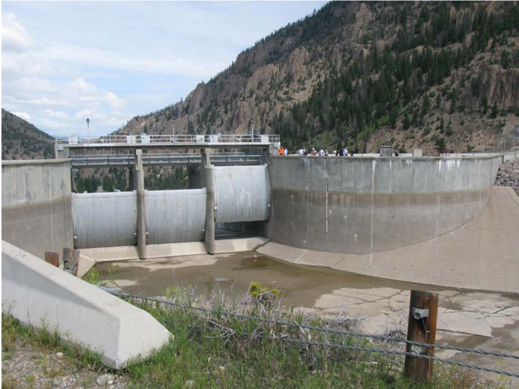
Green Mountain 壩溢洪道弧形閘門開啟關閉測試照片
