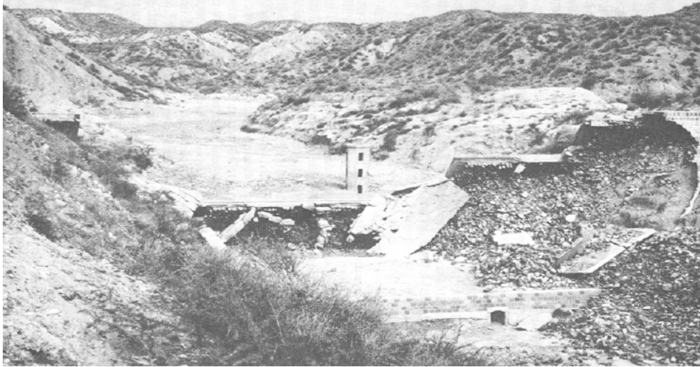
Frias 壩潰壩後照片
