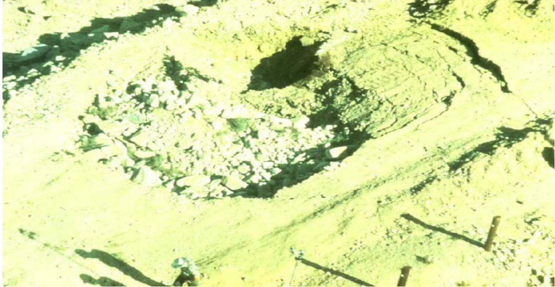
Fontenelle 壩頂坍塌破壞情形(照片下方為工作人員)
