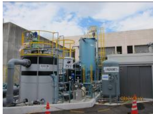
圖 35 霞浦污水廠除磷模廠設備
