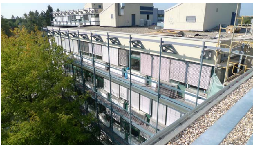
圖 24 屋頂全熱交換機
