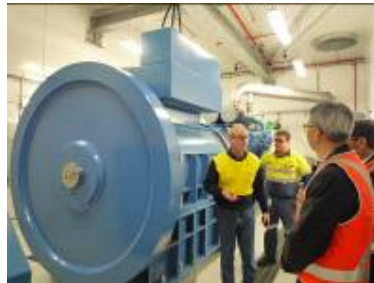
介紹柴油發電機組與 D-UPS
