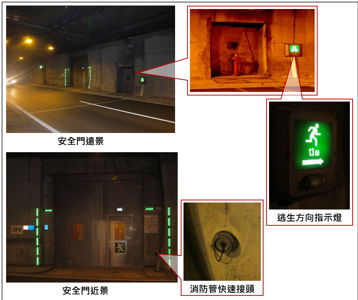
圖3.1.15 緊急逃生安全門（車行橫坑）考察照片-安全門(主線側)
