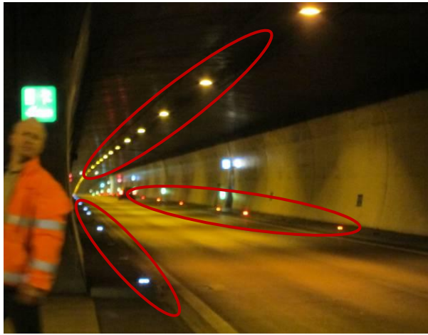
主線照明設施
