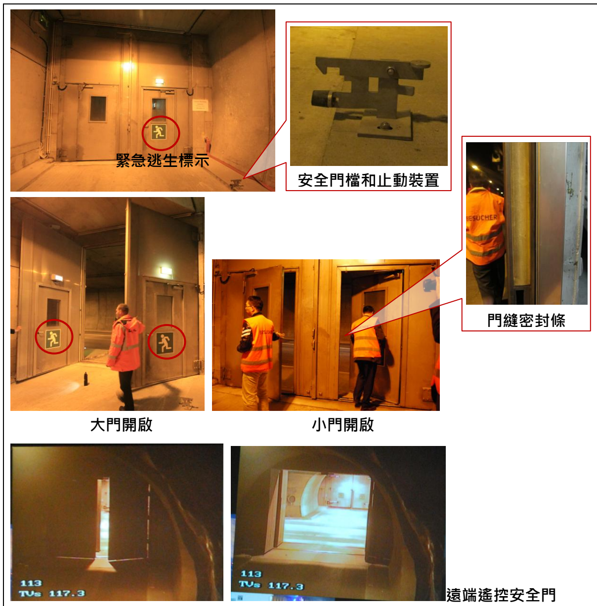
圖3.1.13 緊急逃生安全門（車行橫坑）
