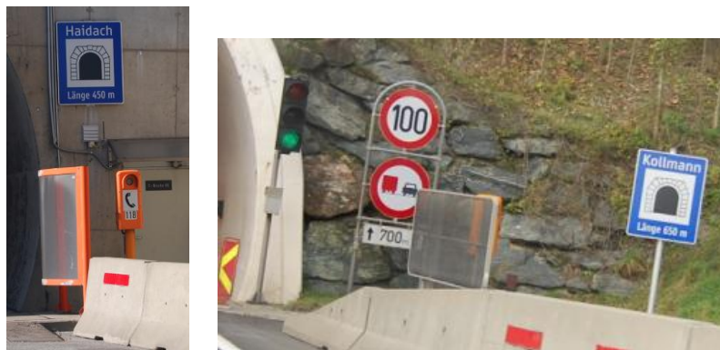
隧道口緊急電話
