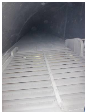
主線平頂排煙孔
