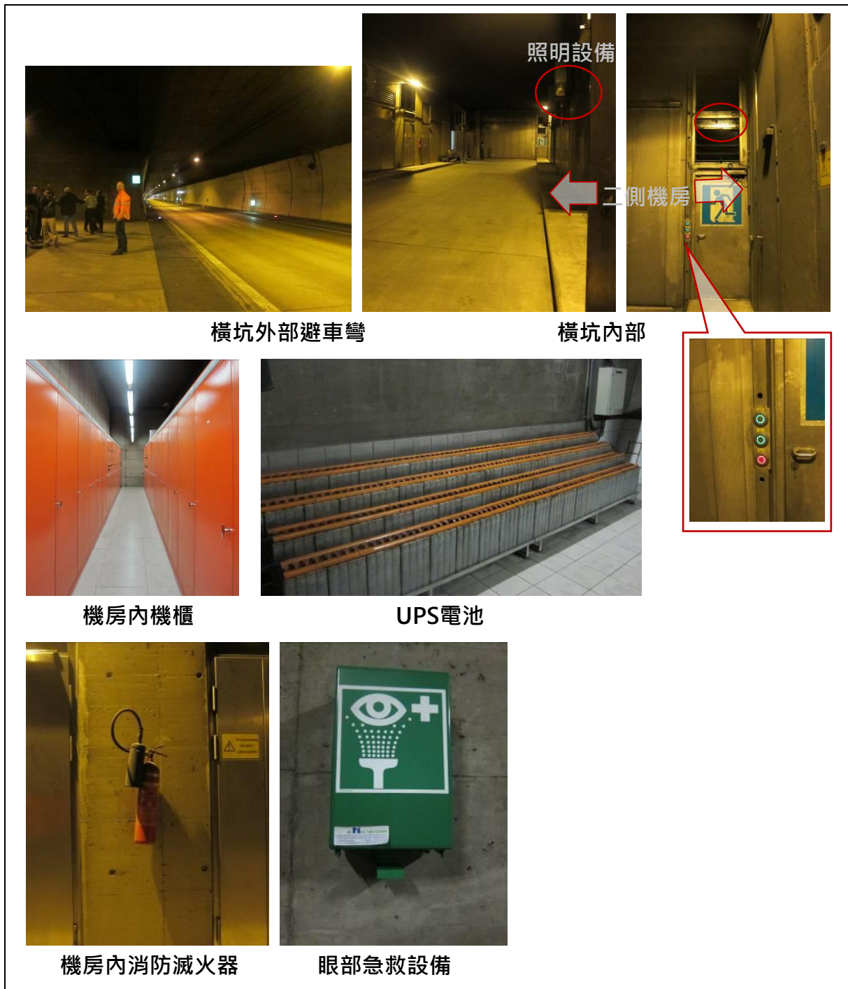
圖3. 2. 12車行橫坑設施
