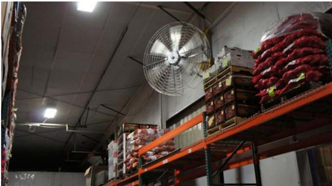
圖 27. General produce company 冷藏庫內調節溫度用大風扇
