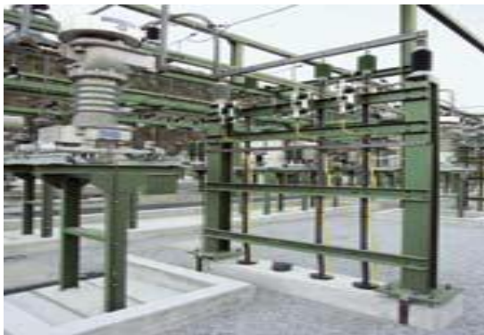
圖120.隧道電力供電設備1
