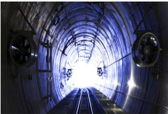
圖136.隧道入口噴射型通風器
