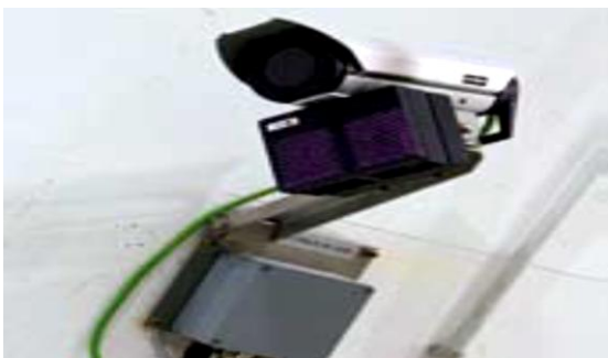
圖138.隧道內監視器
