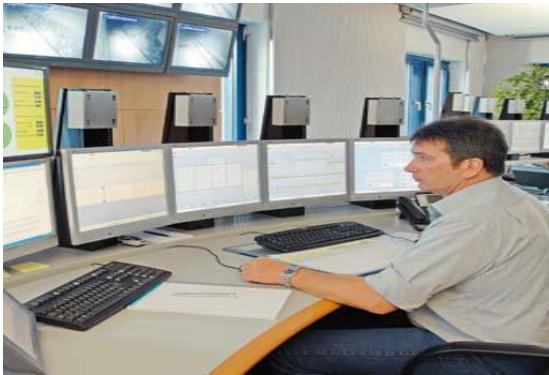
圖128. 營運中心隧道監控1
