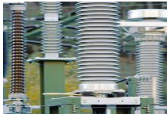
圖121.隧道電力供電設備2
