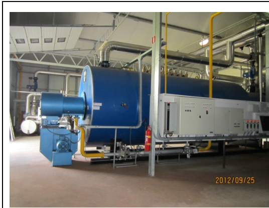
圖 73B.自有電熱共生設備-2
