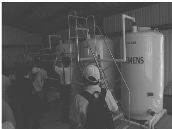
(G) 三段式GAC過濾處理設施
