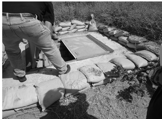
(F) 含TCE污染地下水抽除井
