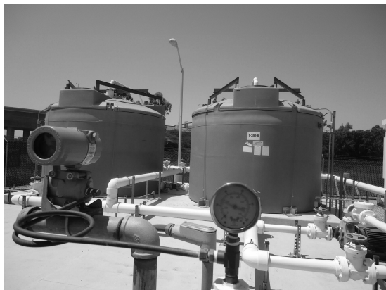
(E) SVE抽取氣體過濾設施
