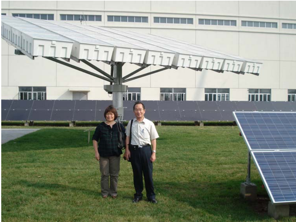
圖三、示範園區之聚光型太陽能發電系統，裝置容量 12.767kWp
