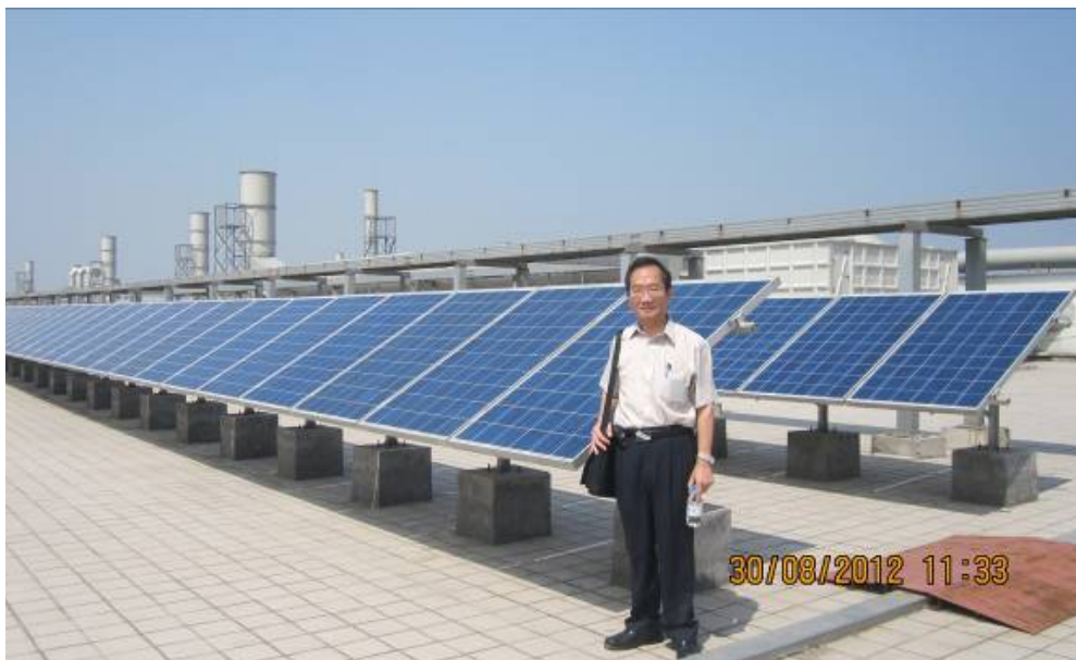
圖四、英利公司光伏屋頂 10MW 併網發電系統之矽發電模組
