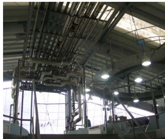
石斑魚苗培育池管線及照明設施
