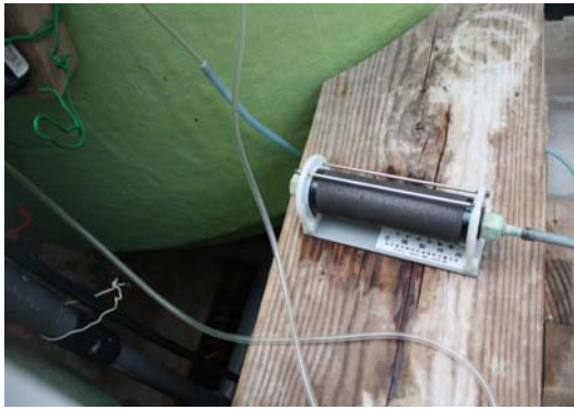
魚苗培育池大型氣泡產生設施
