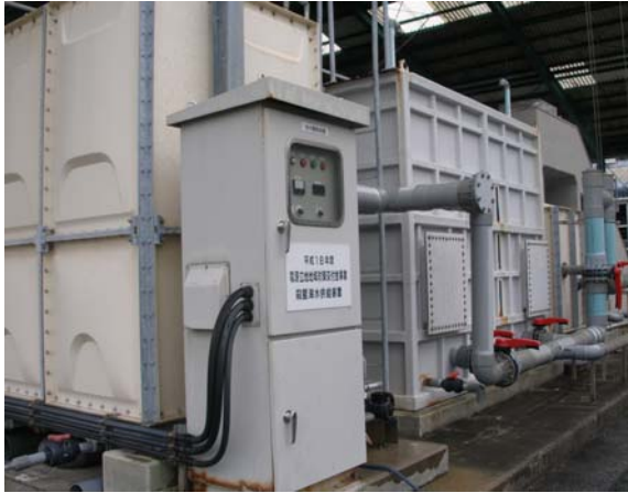
海水電解水設備
