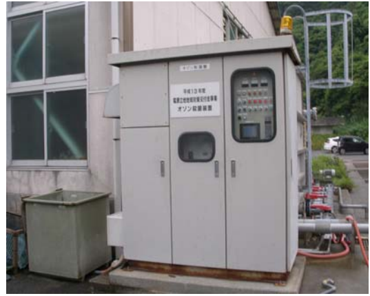
海水電解水設備
