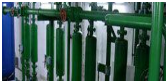
圖6.1-9 Annet-sur-Marne場泵浦及機房
