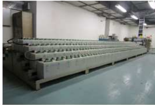
板橋車站 UPS
