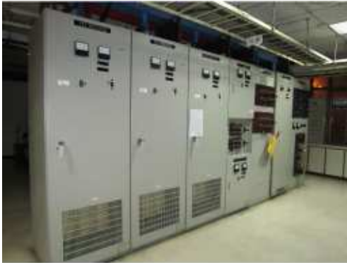
臺鐵大樓 3 樓直流電源供應設備(SMR)
