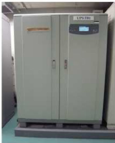
板橋車站 UPS 電池組
