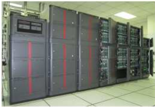
臺鐵局全電子式自動交換機(由 SMR 供電)
