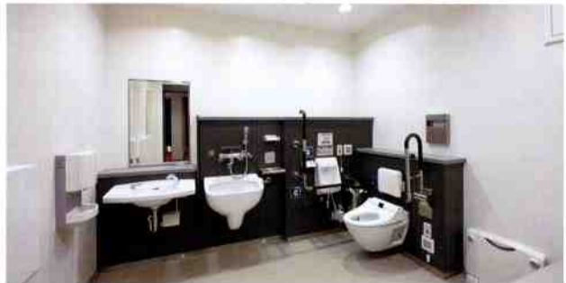
一般トイレ Regular toilets 多機能トイレ Multipurpose toilets
