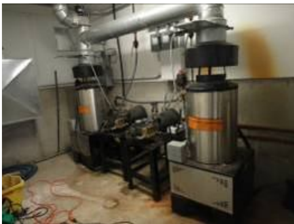
圖 8. 清洗用水加熱設備及工作服清洗場所
