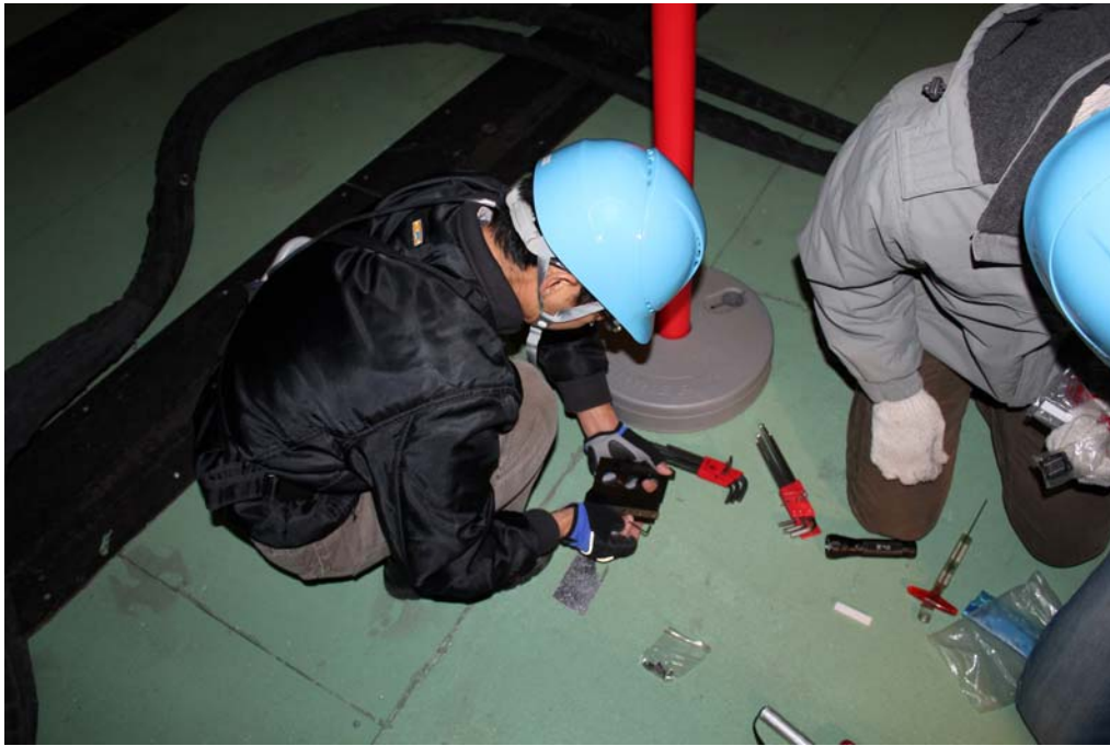
圖 二十四、線性滑軌換裝過程
