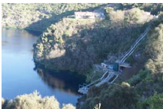
藍湖抽水站全景，包含控制中心（上方房舍）與抽水機組
