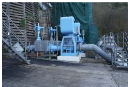
藍湖抽水站三座抽水機組
