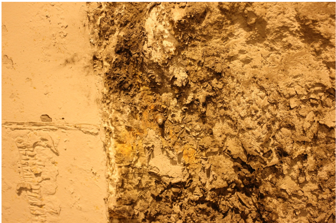
圖 4：連續壁牆面上還有許多灌漿補漿的痕跡。
